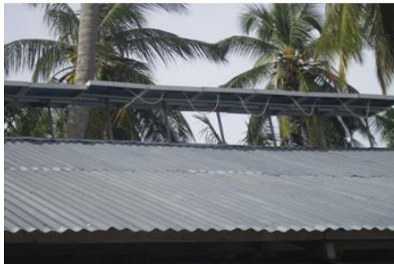
Gambar 3.11. Panel-panel surya yang dipasang di atas atap
