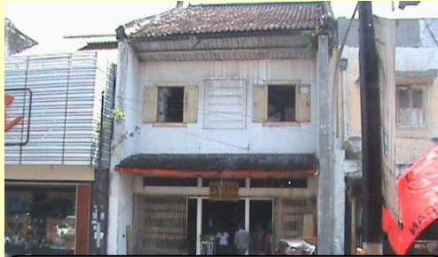
Bangunan Kuno yang kurang terawat Jl. Kapten Mulyadi
